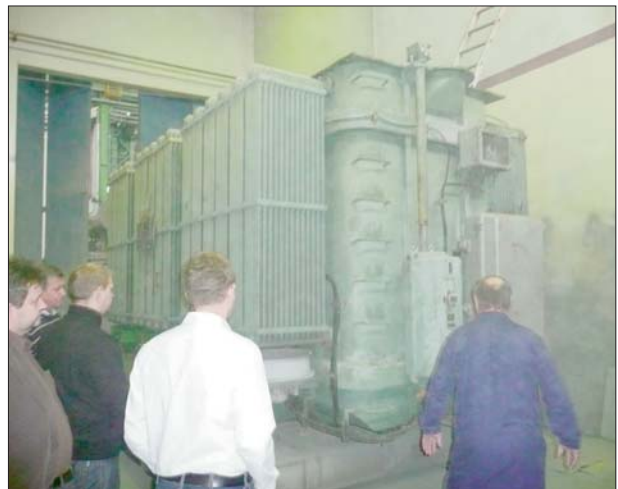
A tápiószelעי gyárba beszállított 40 MVA-es transzformátor tisztítás után
