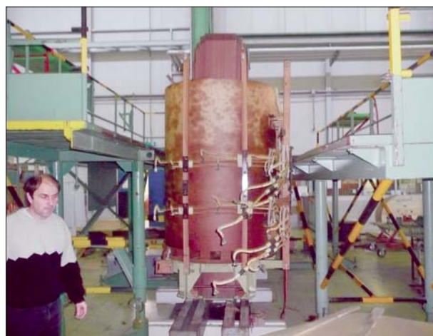
Vasmagzárlat mérésre előkészített, már lecsupaszított, terhelésátkapcsoló nélküli transzformátor
